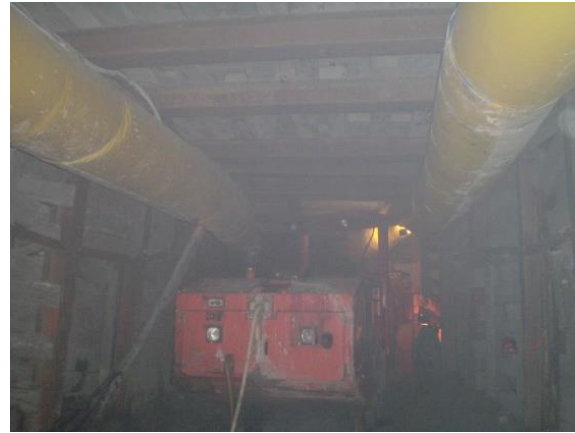
Pipa udara (duct) pada ventilasi lokal
