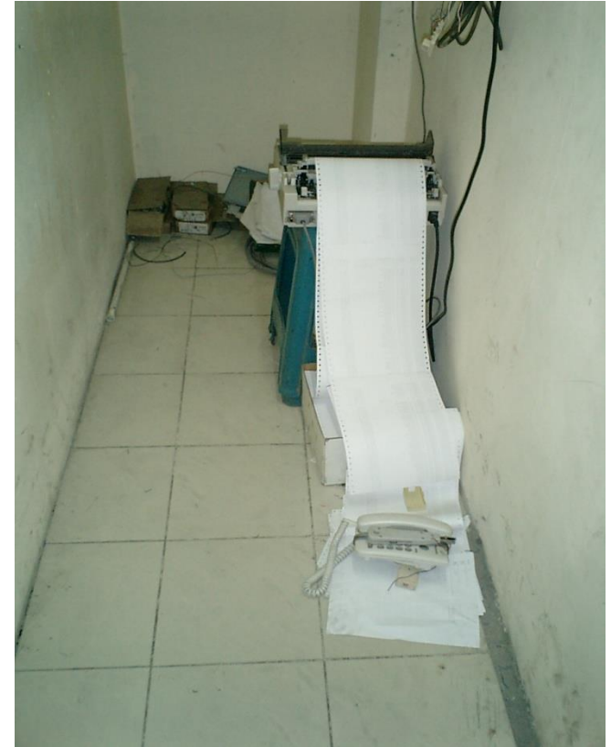
Ruang PABX yang tidak terawat di Gedung Istana Plaza
