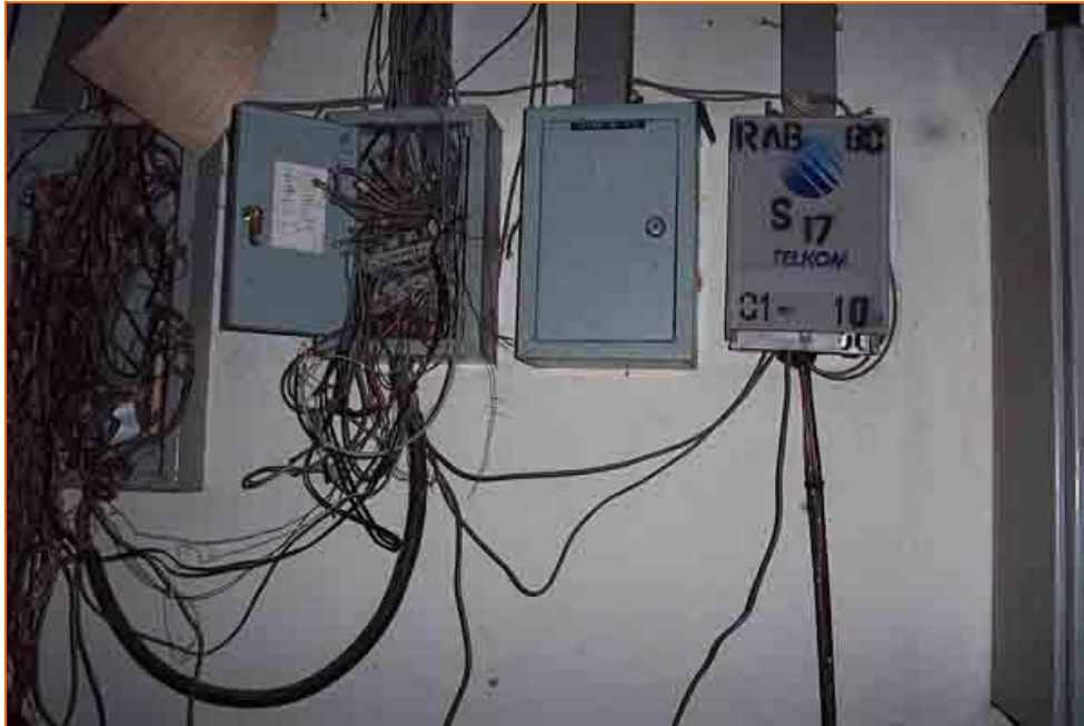
Sistem pengkabelan yang tidak teratur di Gedung Kantor Pos Banda
